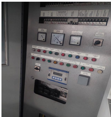
Slika 6. Izgled elektro razvodnog ormana vagona serije Z2
