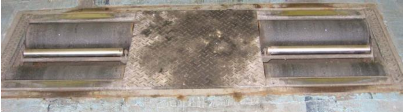
Слика 3.3.4 – Ваљци за проверу исправности уређаја за заустављање
